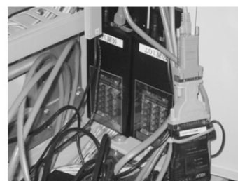
図 2.5. 電力使用量リアルタイムモニタシステム
